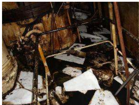
写真9. 機関室内の油の状況
