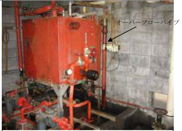
写真2 サービスタンクとオーバーフローパイプ
