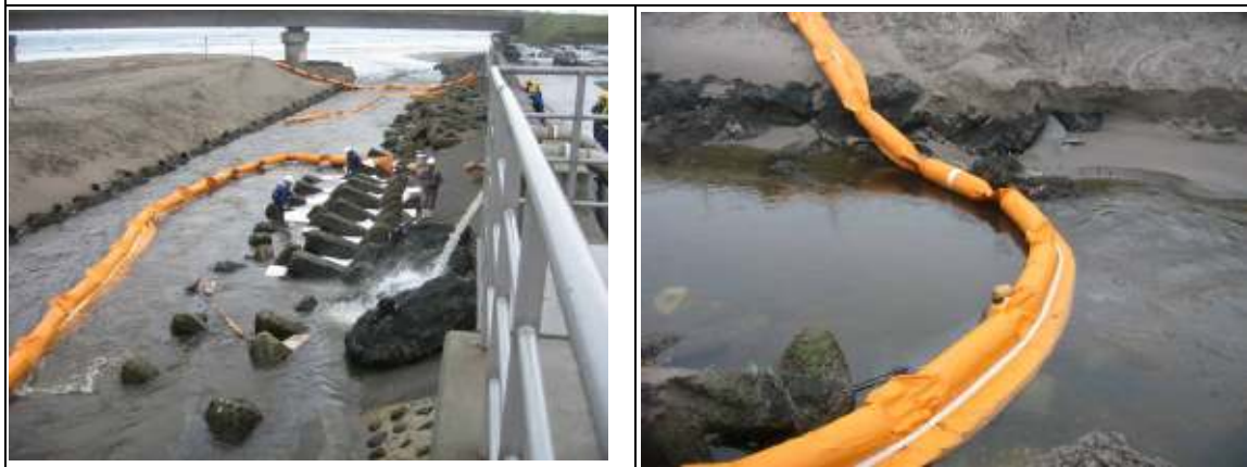
写真11 油は水路から水門を経て南部陣屋川へ / B型OF3通りに地元消防により展張
