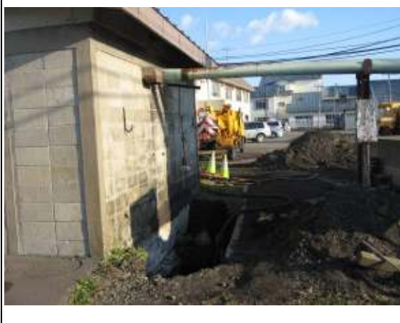
写真5 サービスタンク小屋と油漏洩部掘削
